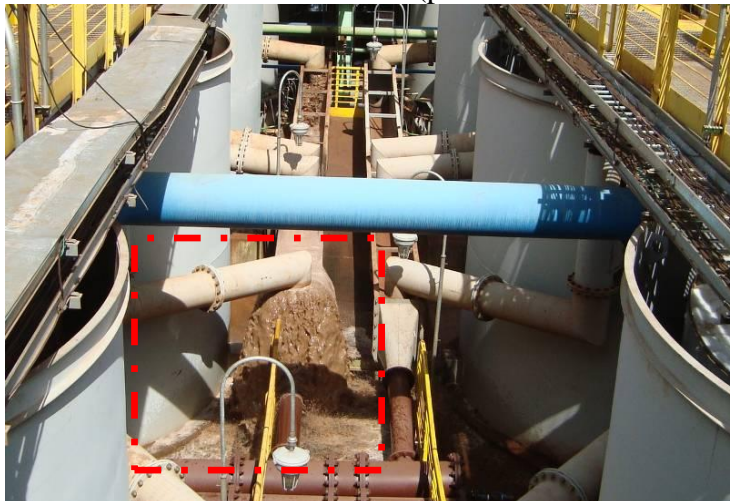
Figura 8- Foto transborde de material (póla de minério de ferro)
