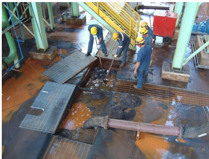
Figura 9- Foto entupimento de calhas
