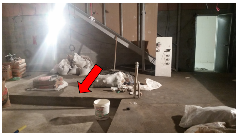
Figura 6 - Foto tirada da cozinha, após execução do contrapiso com 21 cm de elevação em relação ao restante do restaurante Fonte: Próprio autor (2015)
