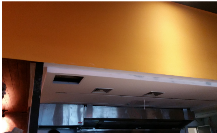
Figura 7 - Forro de gesso da cozinha alinhado na parte externa (testeira) com forro de madeira Ipê Fonte: Próprio autor (2015)
